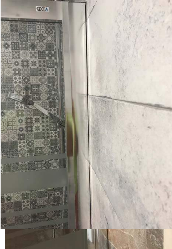
FOTO 26: VISTA GENERAL JUNTA DE MAMPARA SIN SELLAR EN ASEO 1
