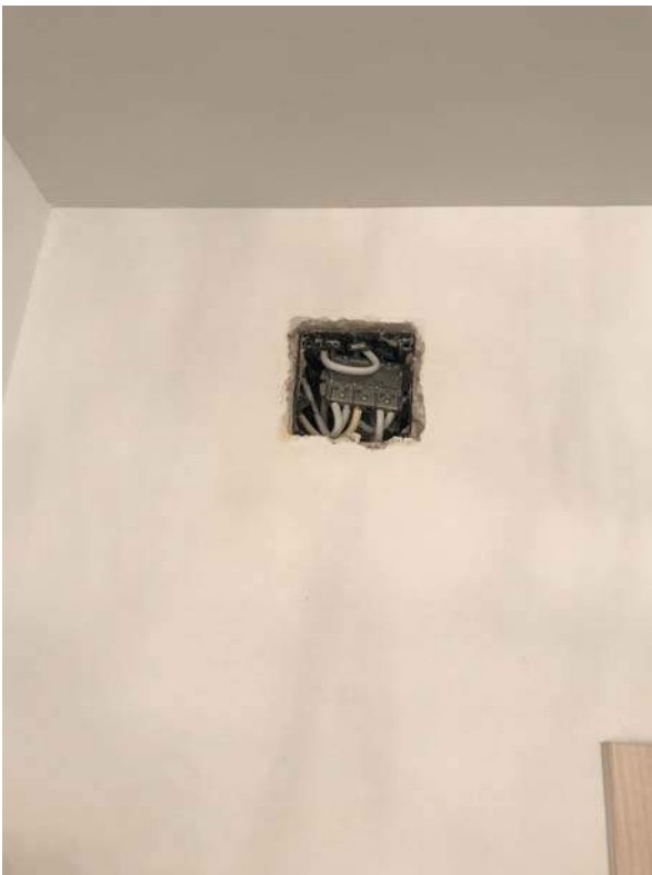
FOTO 17: CAJA REGISTRO ANTENA EN DORMITORIO PRINCIPAL
