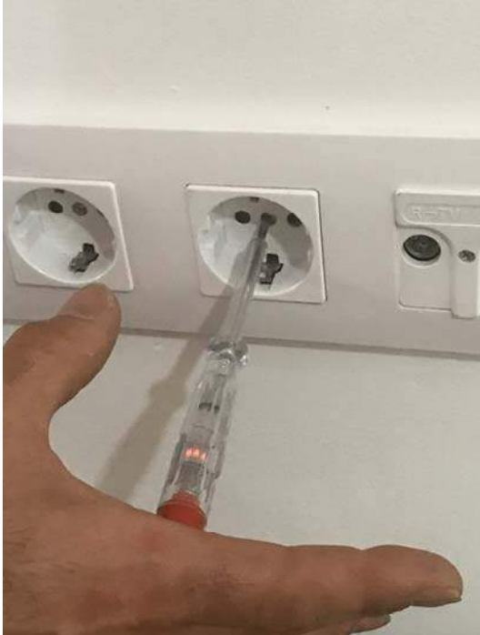
FOTO 19: PRUEBA TESTEO DE DERIVACION DE CORRIENTE EN ENCHUFES DE LA VIVIENDA. DANDO POSITIVO
