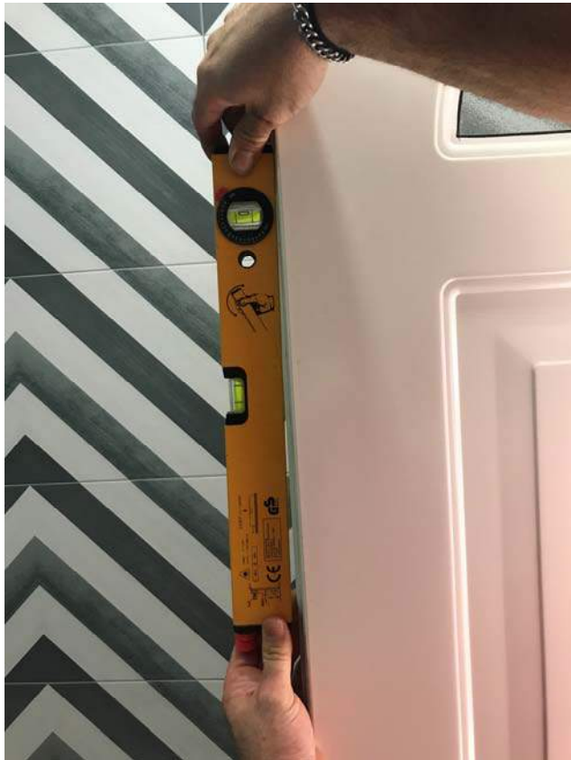
FOTO 28: VISTA JUNTA SIN SELLAR MAMPARA ASEO 2
