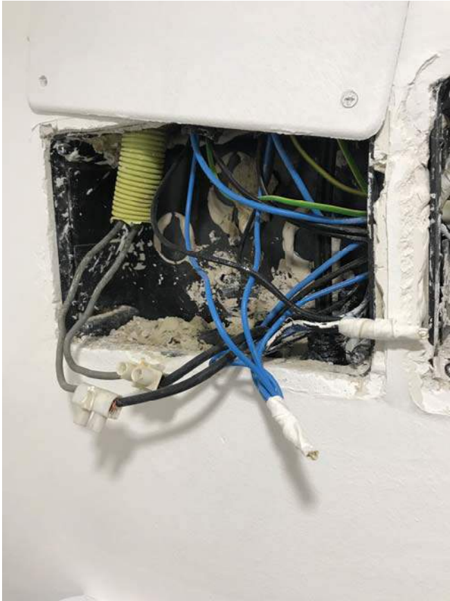
FOTO 8: CAJA REGISTRO PASILLO 1 ENCIMA CUADRO GENERAL CON LINEA DE ACOMETIDA
