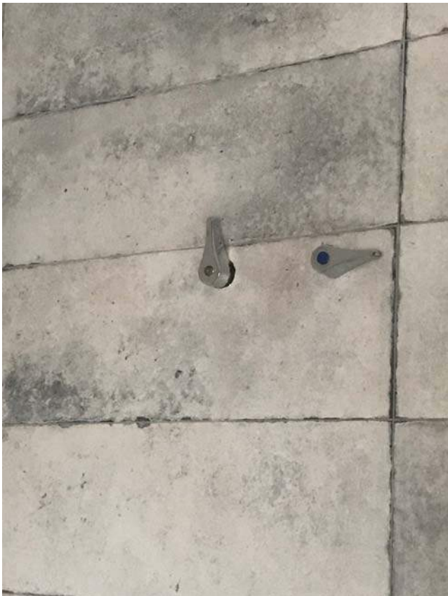
FOTO 25: VISTA GENERAL LLAVES DE CORTE DE ASEO Y BAÑO
