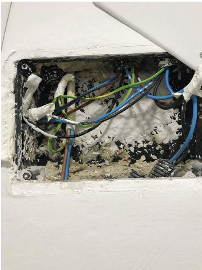
FOTO 9: CAJA REGISTRO PASILLO 1 ENCIMA CUADRO GENERAL PARA DISTRIBUCION VIVIENDA
