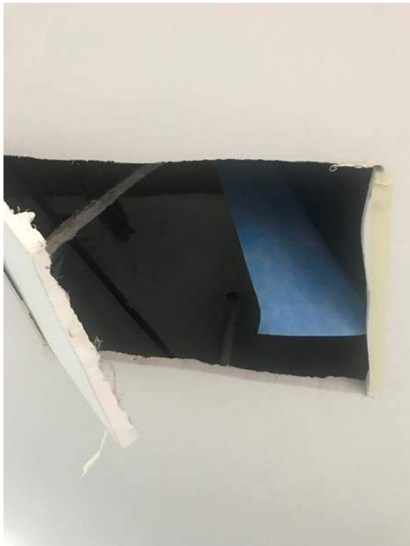
FOTO 31: APERTURA EN FALSO TECHO ZONA CON HUMEDAD
