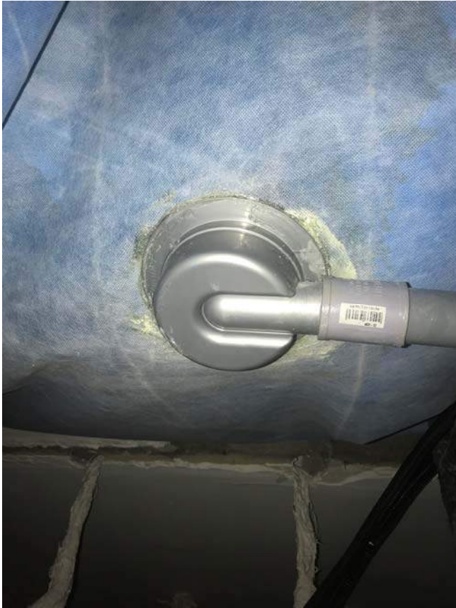
FOTO 32: RECOGIDA AGUAS PLUVIALES EN PATINILLO
