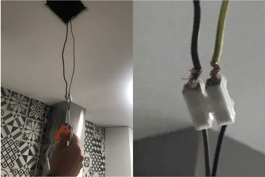
FOTO 20: VISTA GENERAL LANPARAS TECHO COCINA Y DETALLE DE CONEXION
